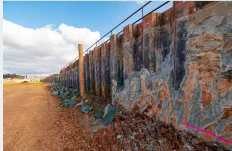
Pohled na štětovou stěnu v 1. KÚ s dosud neodtěženými zbytky jílocementostruskové směsi z TPS
