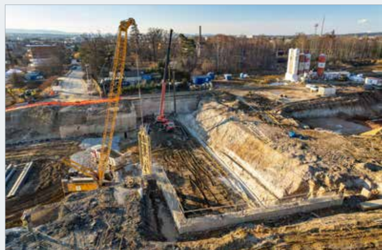
Těžba lamely podzemní stěny a beranění štětovnic příčné dělicí stěny v 1. etapě výstavby na Pražském portále
