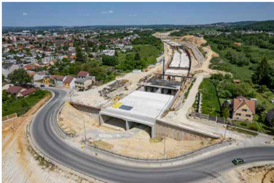
Pažení stavební jámy Kaplického portálu podzemními stěnami s dokončovanou hrubou vestavbou tunelu
