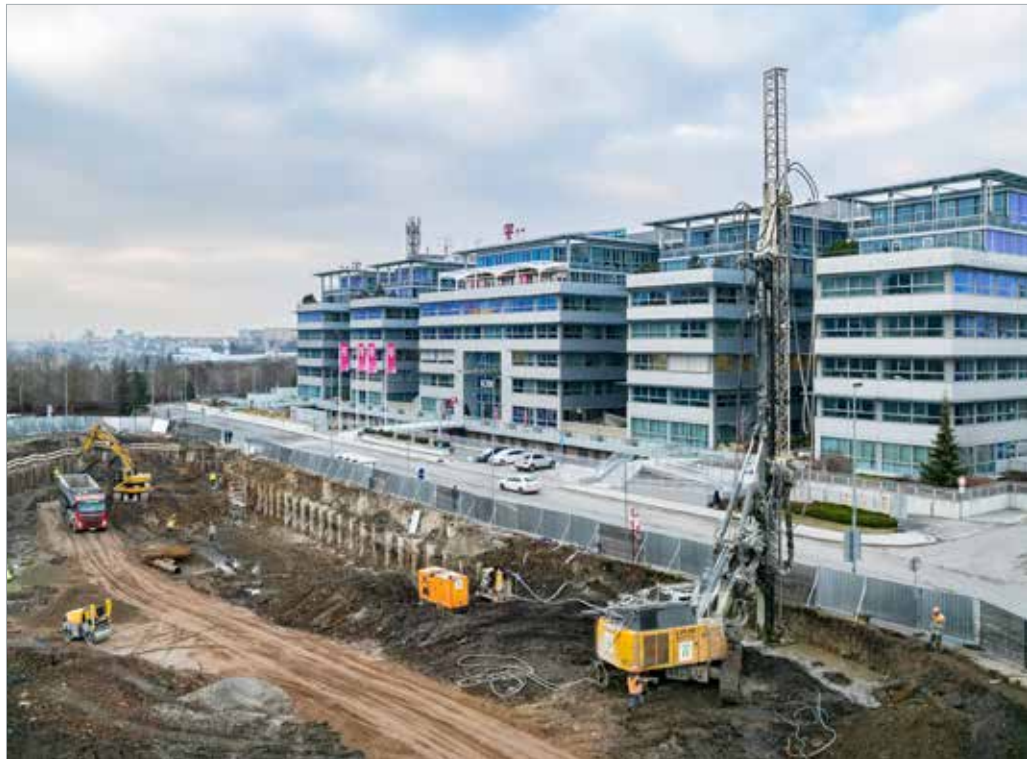
Provádění dotěsnění prostoru mezi pilotami půsloupky tryskové injektáže upravenou vrtnou soupravou Liebherr LB 16
