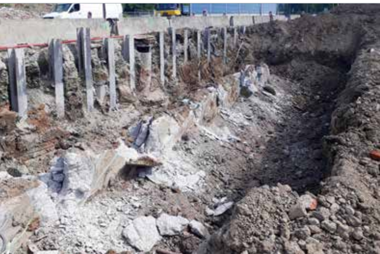
Objekt C202, osazené záporny pro pažení silnice I/42 – ul. Žabovřeská a bourání železobetonové konstrukce historických sedimentačních bazénů
