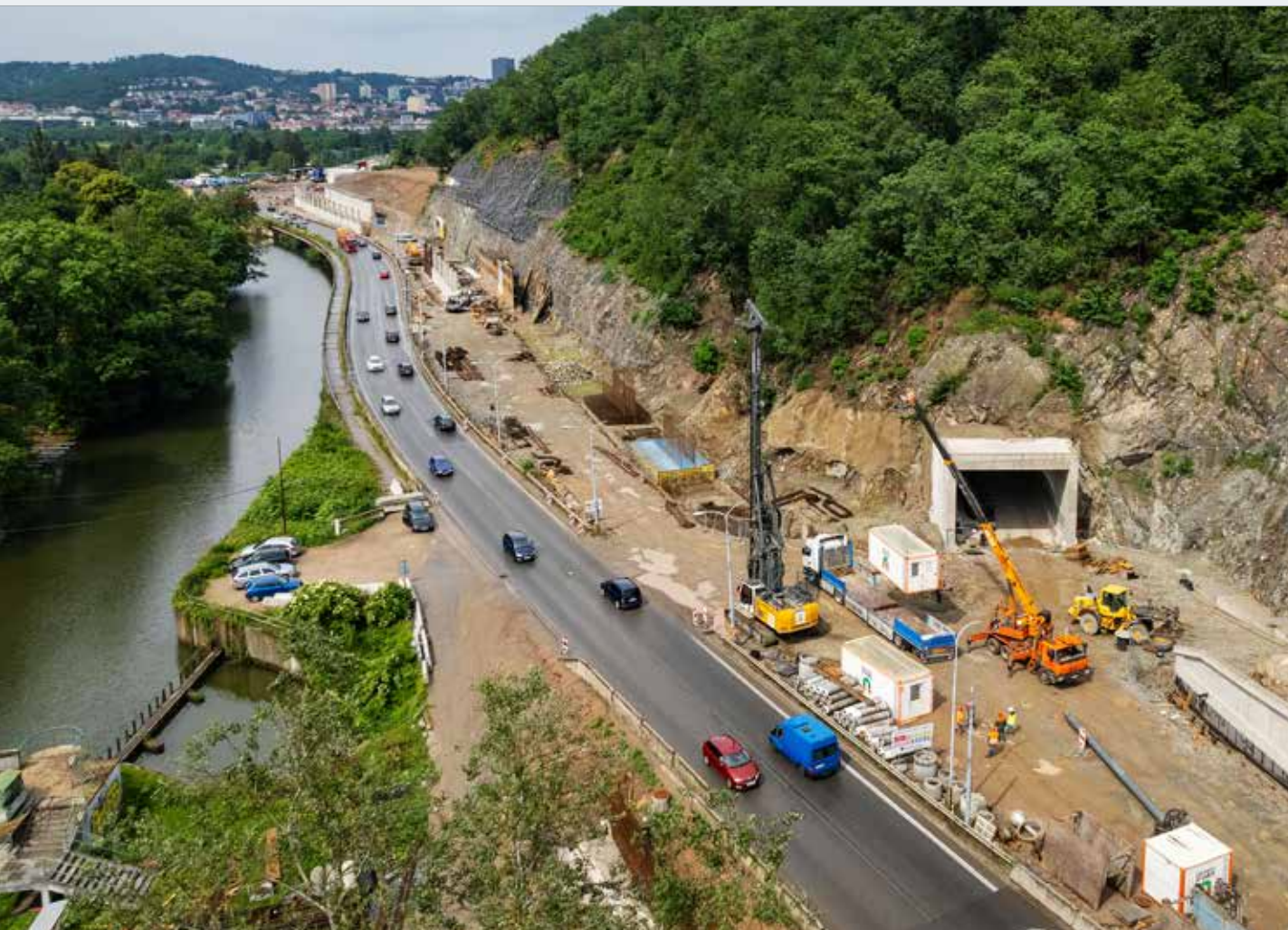
Pilotové zakládání ve střední části aktuálně budovaného VMO Žabovřeská I – etapa II v místě portálu nového tramvajového tunelu
