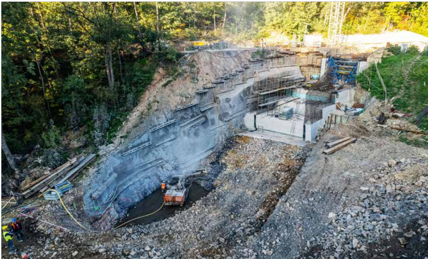
Stavební jáma s nově budovanými konstrukcemi skluzu a vývaru, hloubení vrtů pro kotvení pažení vývaru
