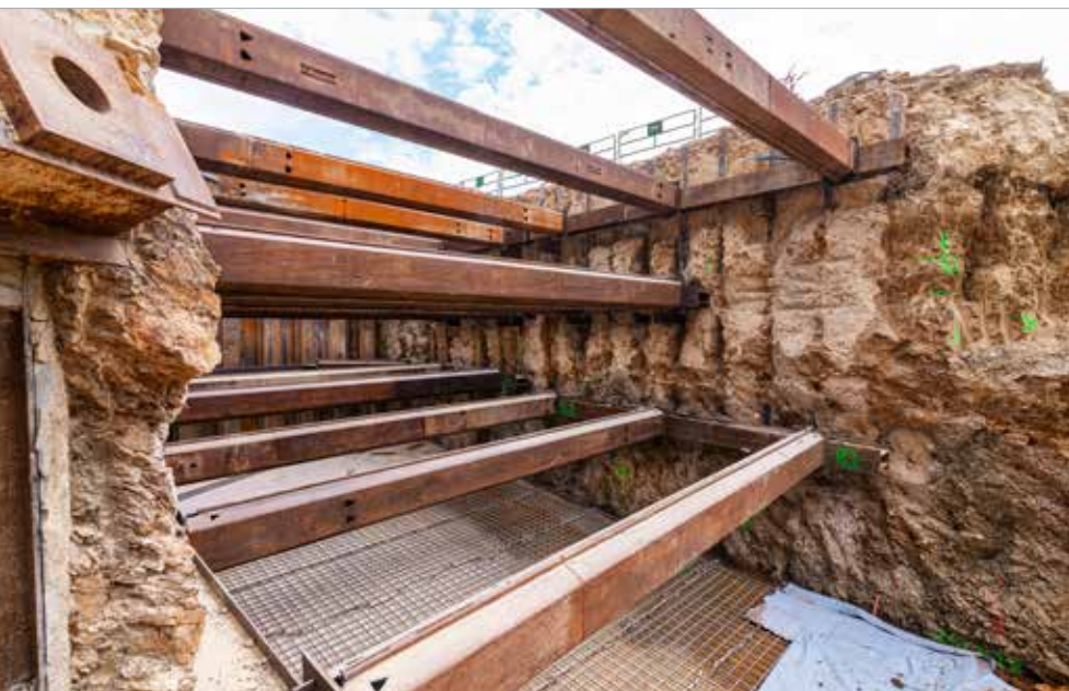
Stavební jáma v místě překopu hráze pažená sloupky dvouřadé tryskové injektáže a rozepřená ve třech úrovních
