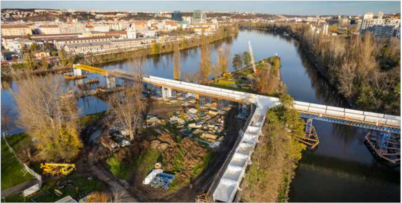
Celkový pohled na vznikající konstrukci lávky s rampou na ostrov Štvanice, vpravo je plavební kanál, vlevo mělké nesplavné koryto Vltavy.
