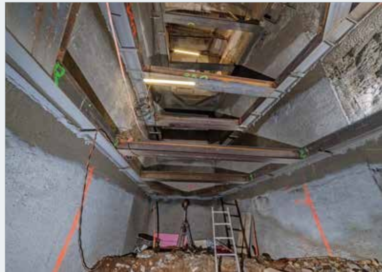
Výkop pro objekt B11, podchycení a pažení sloupy TI a rozepřeno ve třech úrovních
