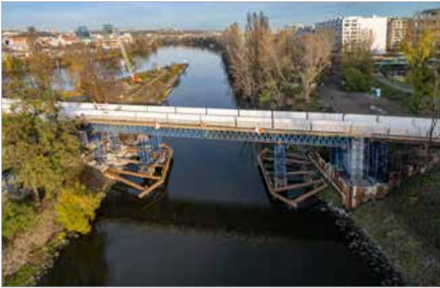
Nosná konstrukce lávky v plavebním kanálu podepřená montážní skruží se dvěma dočasnými podpěrami založenými na mikropilotách s navazujícím nutným opeřením rozepřeným do břehové části
