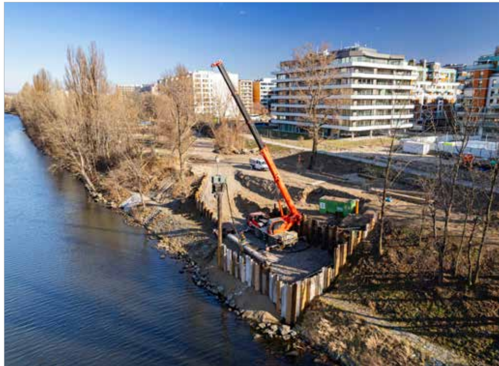
Pracovní plošina v příkrém karlínském svahu pro pilotové založení piliře P10 byla zajištěna štetovou jímkou.
