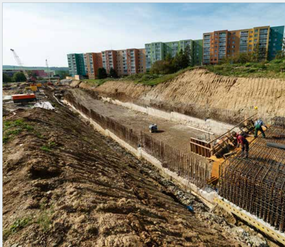
Pohled na odtěženou a začištěnou korunu podzemní stěny, vpravo probíhá armování stropní konstrukce
