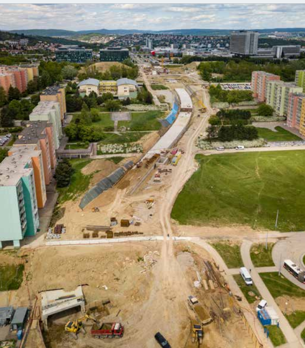
Trasa nové větve tramvajového tratě vedená v tunelu, pohled od zastávky Osová směrem ke kampusu MU
