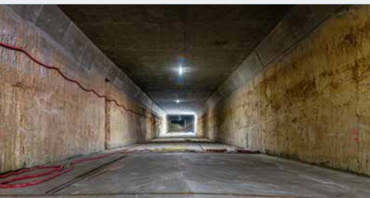
Pohled do tunelu – začištěné podzemní konstrukční stěny s dokončeným stropem a základovou deskou
