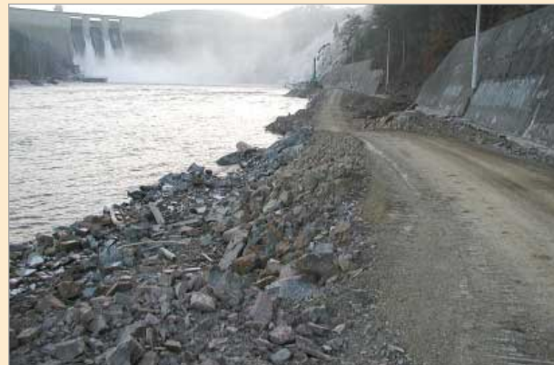
Poškozený břeh a provizorně nasypaná cesta pro obsluhu vodní elektrárny Orlík
