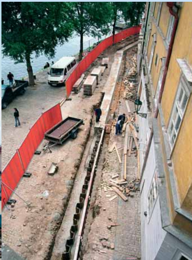
Obr. 7a: Pohled z Karlova mostu na těsnicí štětovou stěnu pro vodu Q_{50} na Kampě
