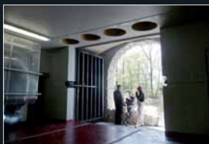
Unikátní protipovodňová vrata otevírají vstup do tunelu 2 + 3 z Vltavy, ve stropu otvory odvádějící "využitý" vzduch (5/2012)
